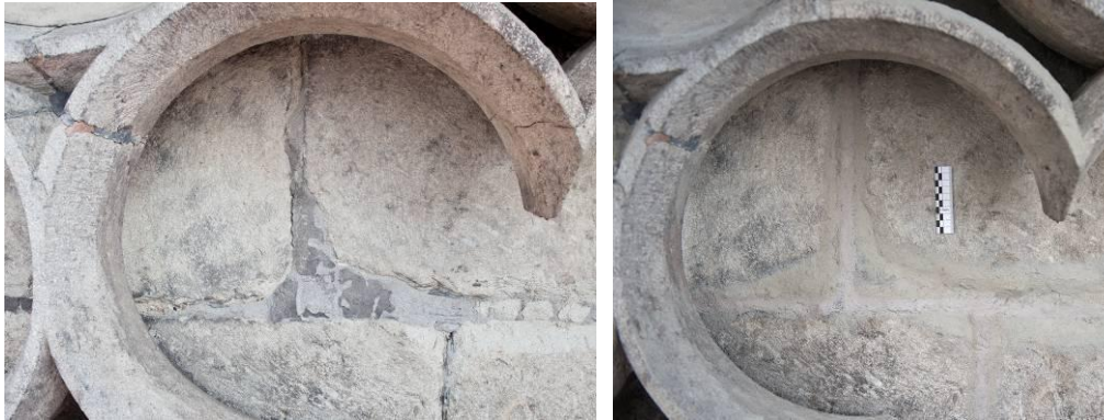
Köln, Dom, Fenster S 3, Wandfläche im Maßwerk, vor (links) und nach (rechts) der Konservierung © Dombauhütte Köln / Foto: M. Unkelbach
